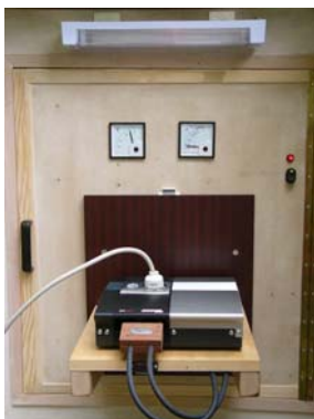
Die Solar-Tankstelle liefert Solarenergie aus der Steckdose
